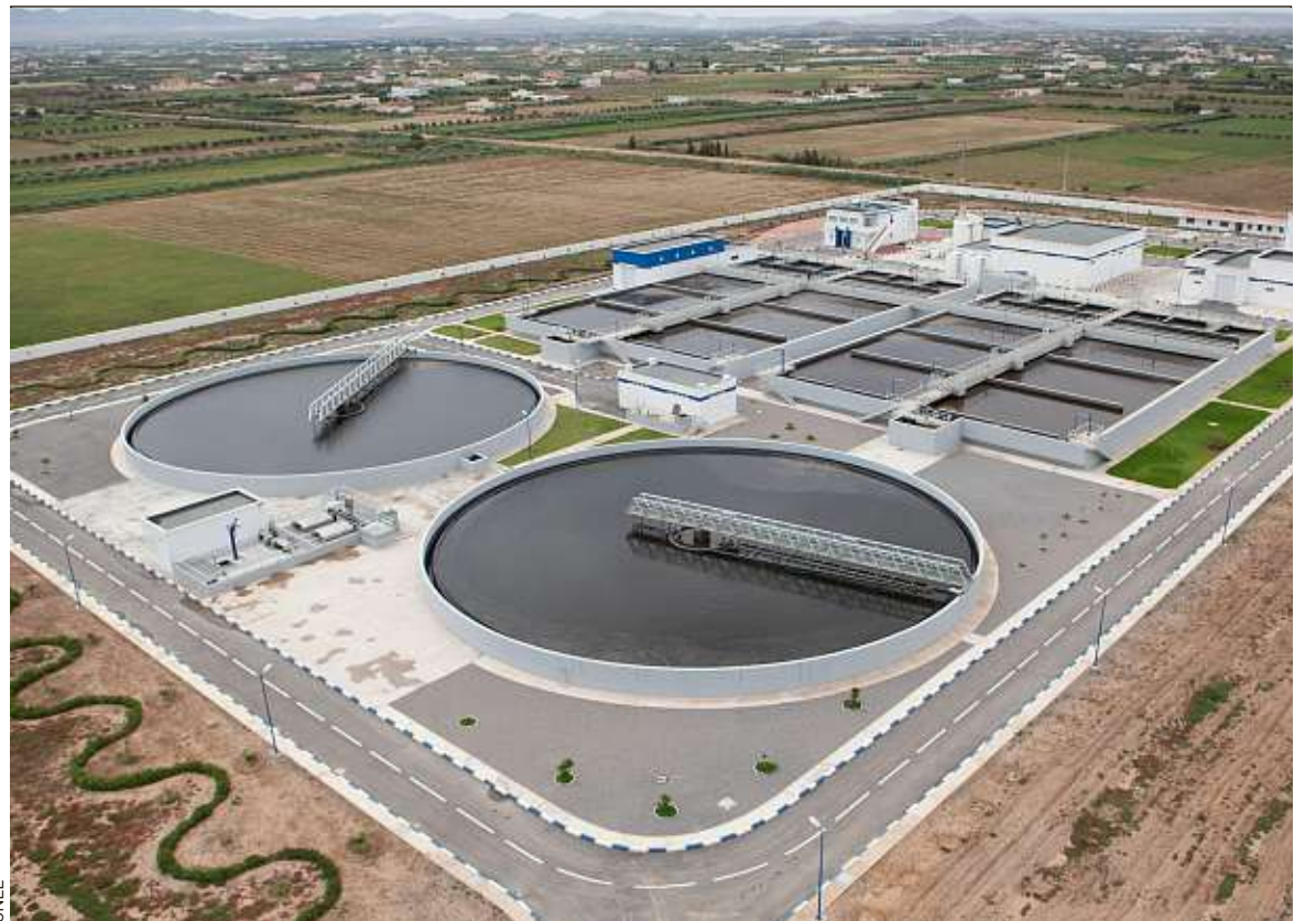
La station d'épuration de Nadour, au Maroc, mise en service en 2010, traite les odeurs de la lagune de Marchica.
